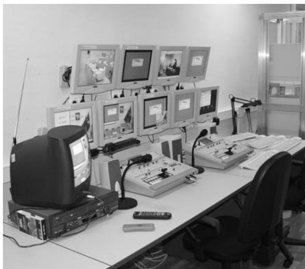
Рисунок 5. Размещение оборудования в аппаратной центральной точки
